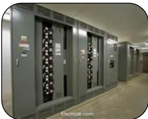
Salas elétricas (painéis, salas de controle e equipamentos elétricos em geral)
